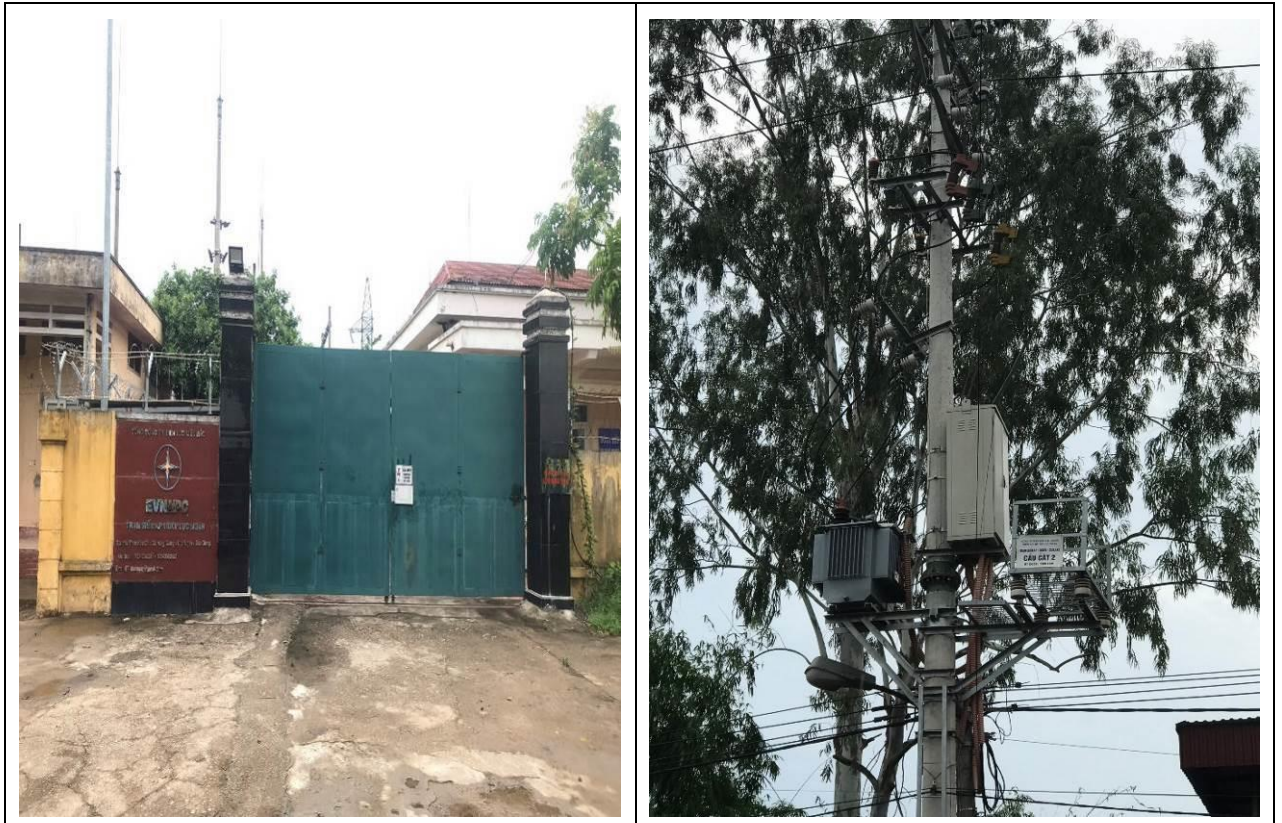
Hình 1.11. Hiện trạng hệ thống cấp điện
